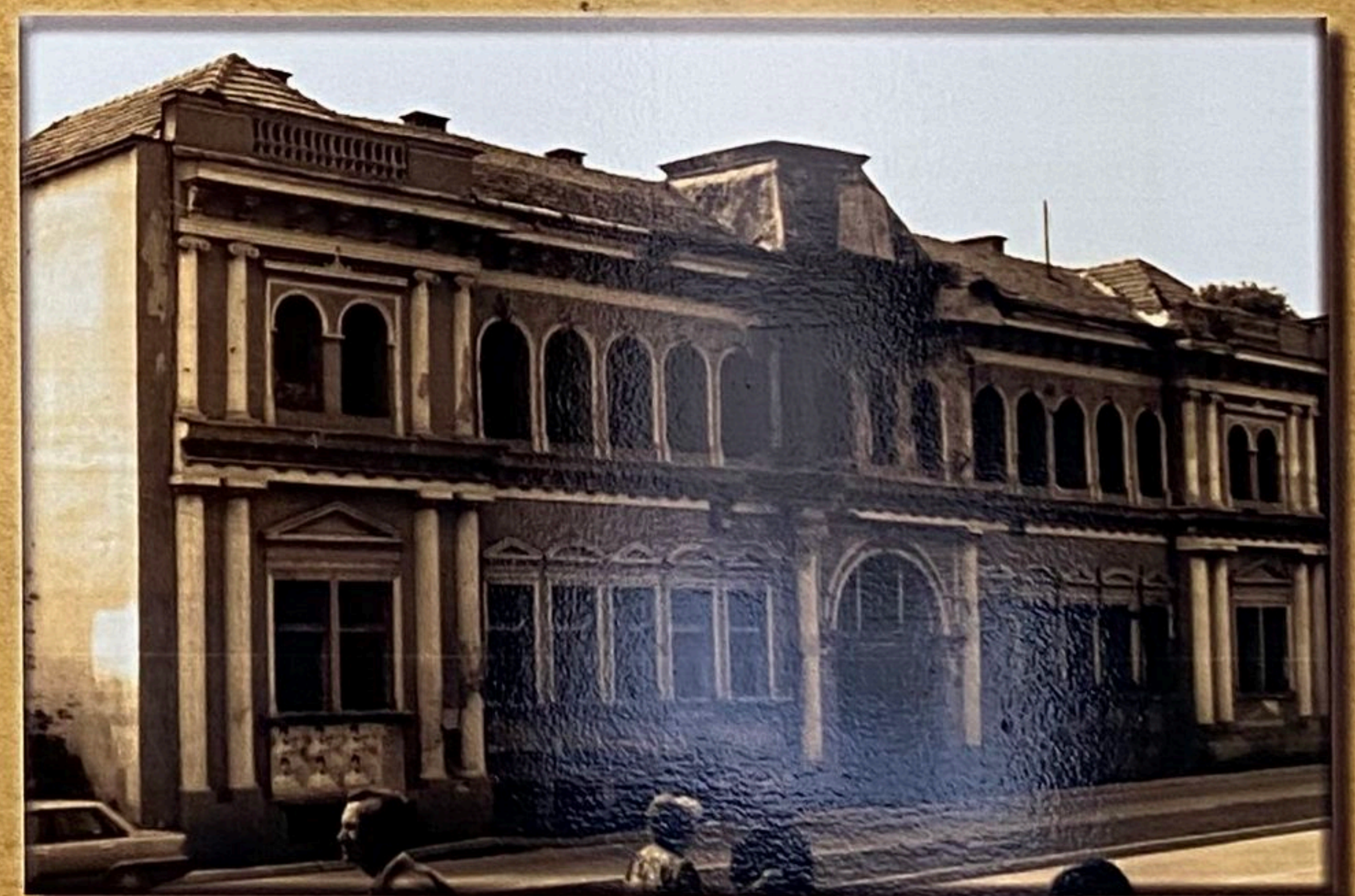
Fotografija na kojoj je vidljivo loše stanje zgrade. Ista je srušena 2015. godine. (BiH - ATKI/FTG Z)
